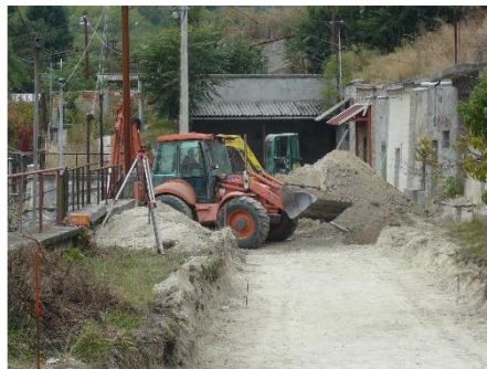
Terméskő burkolási munkálatok csapadékvíz elvezetéséhez az Egri Szépasszonyvölgyben (Megrendelőnk a Nap-Tér Invest Kft.)
